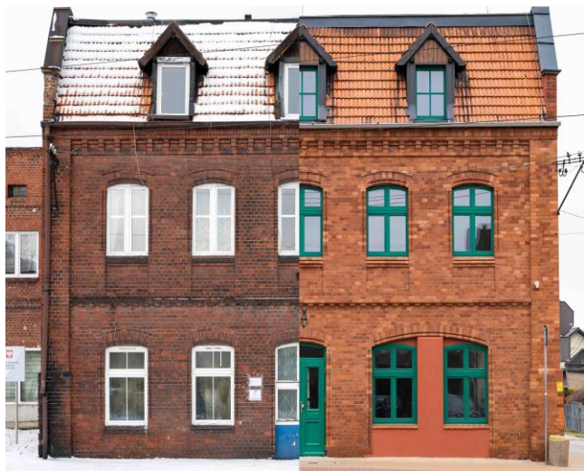
Termomodernizacja zabytkowego budynku w Tychach, źródło: Miejski Zarząd Budynków Mieszkalnych w Tychach
